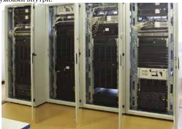
Серверные шкафы ЕАСО ГПИ
