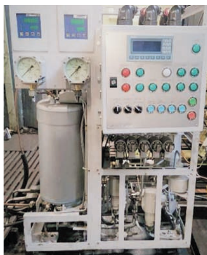
Рис. 8. Блок осушки азота 29Б0-1/350
