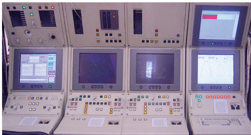
Рис. 5. Внешний вид средств управления системами управления
