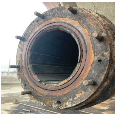
Рис. 2. Излом на конце резинометаллического подшипника (ГОСТ 7199–77)
