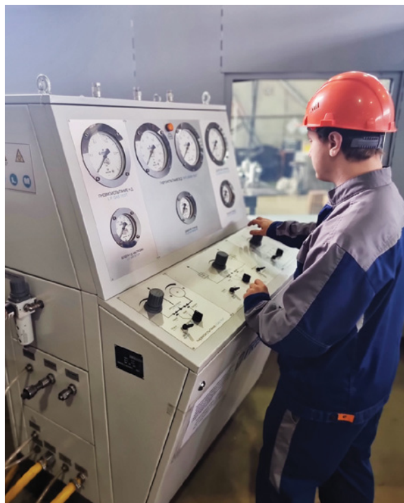
Пульт управления стенда пневмо- и гидроиспытаний
